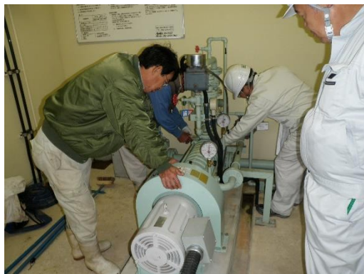
排水ポンプ施設診断
