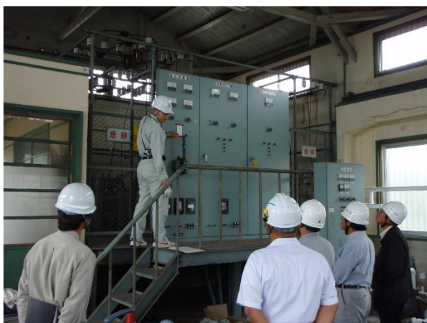
排水機場の操作説明
